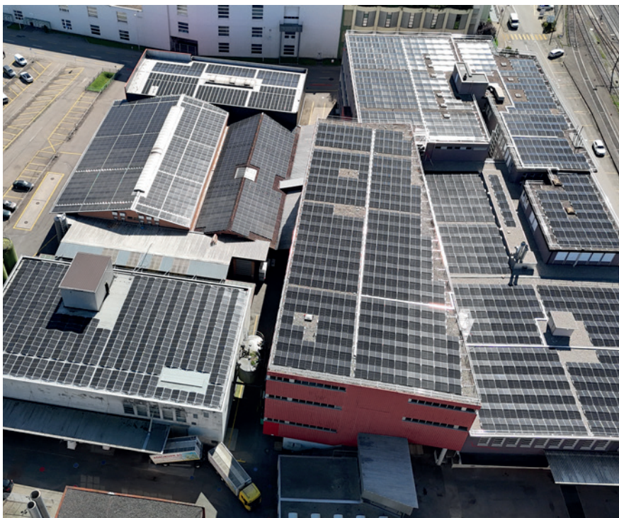
Umgesetzte PV-Anlage in Bischofszell 2024, 1400 kWh
